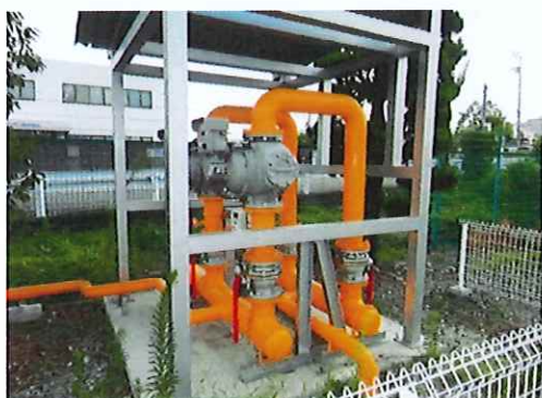
転換後の都市ガス機器の様子
